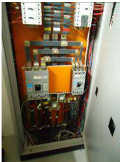
Fig. 3.16. Quadro elétrico principal.
