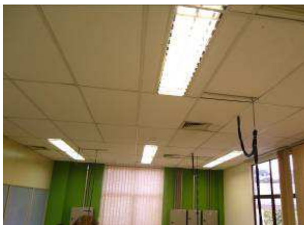
Fig. 3.33. Sala de Desenvolvimento de Hardware
