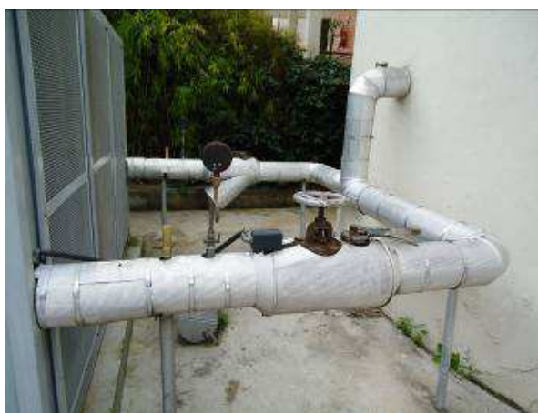
3.11. Circuito de água do chiller (antes da reforma)
