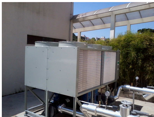
Fig. 3.23. Novo Chiller 60 TR
