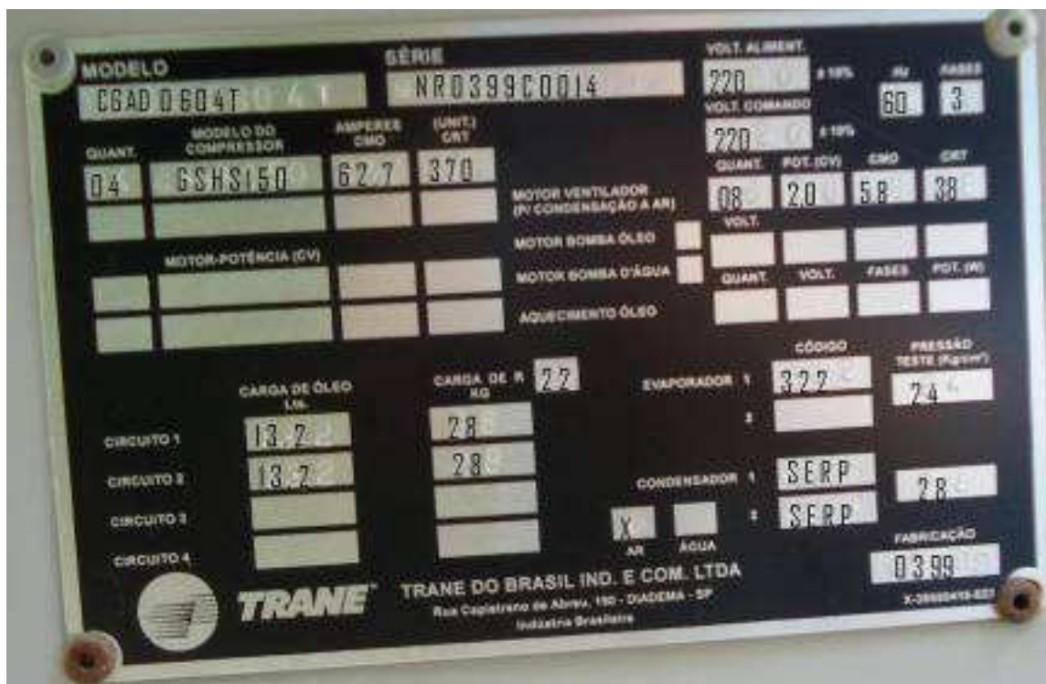
Fig. 3.10. Dados de placa do chiller antigo com condensação a ar
