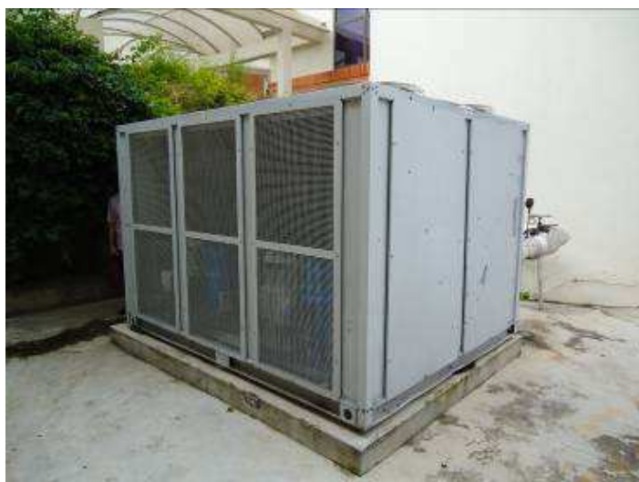
Fig. 3.9 Chiller condensação a ar
