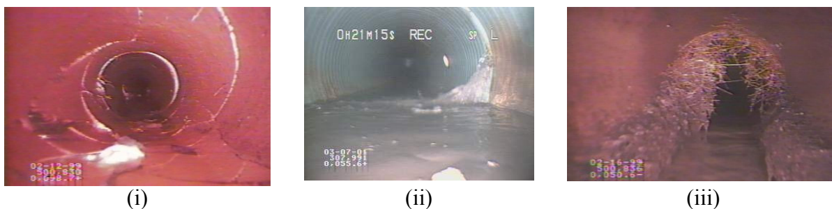
Figura 2.1 Problemas encontrados durante uma inspeção de instalações. Da esquerda para a direita: (i) quebra nas tubulações; (ii) infiltrações; (iii) raízes dentro da tubulação (fonte: Metropolitan Sewer District, 2003).
