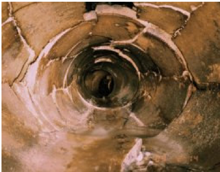
Figura 1.1 Exemplo de tubulação em uso, em pobre estado de conservação (fonte: Paul Hayward Associates).
