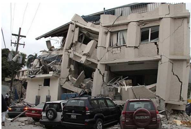
Figura 1.3 – Edificações danificadas pelo terremoto Haiti –Porto Príncipe 2010 (7,0 pontos na Escala de Richter)
