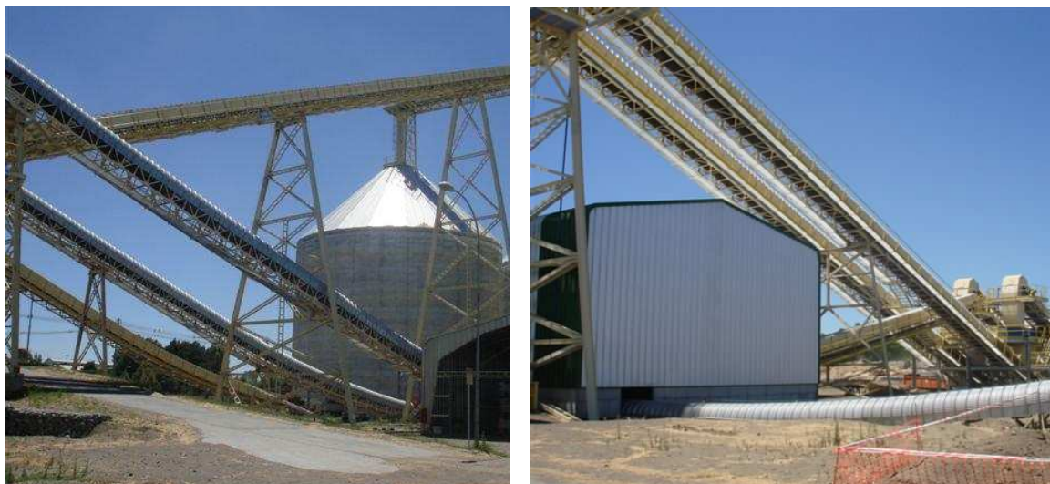
Figura 1.5– Transportadores de Correia instalados numa fabrica de MDF e MDP em Cabrero – Chile
