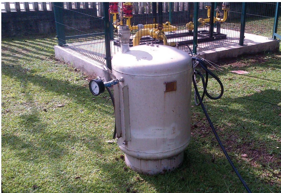
Figura 5.4 – Vaso de acumulação instalado (fonte: O Autor, 2015).
