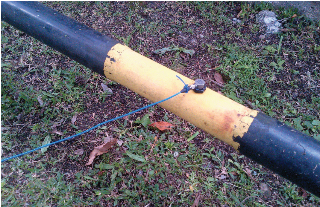
Figura 5.8 – Detalhe da fixação dos acelerômetros (fonte: O Autor, 2015).
