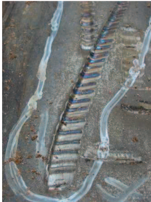
Figura 2.2 – Rasgo superficial (fonte: Pipeline OZ, 2015).
