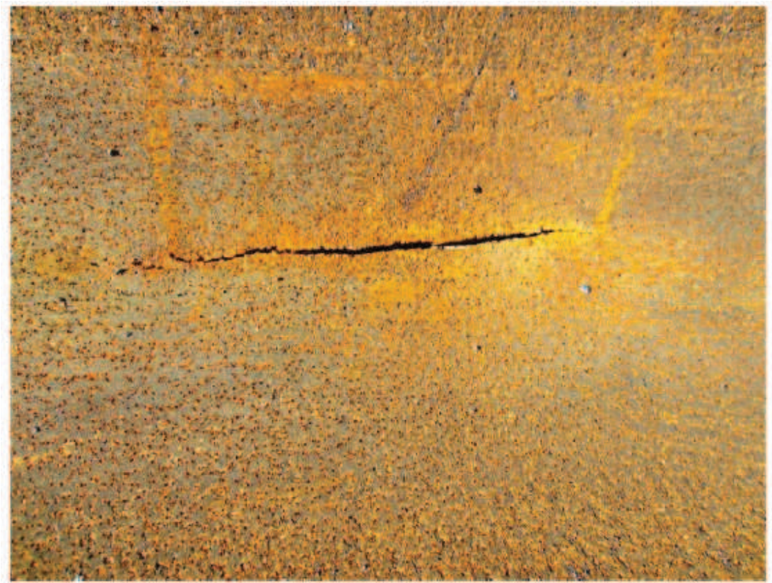
Figura 2.4 – Trincas superficiais (fonte: MOGHADAM et al. , 2015 ).
