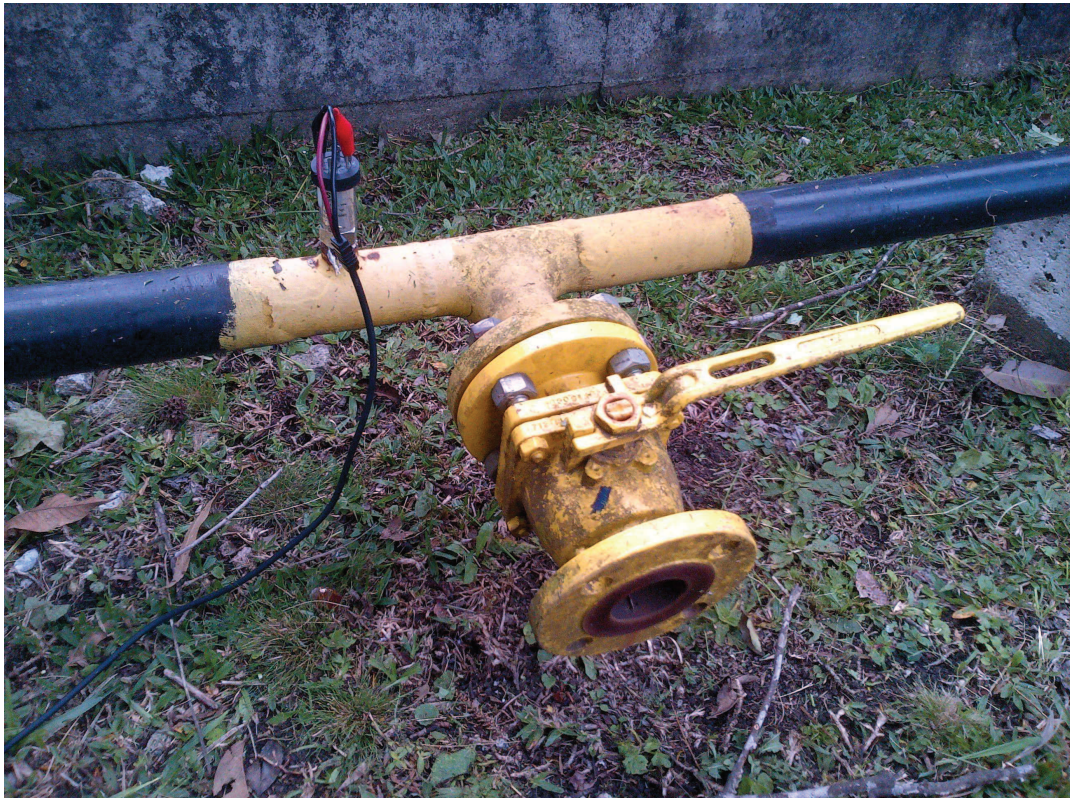
Figura 5.7 – Detalhe da instalação do transdutor de pressão (fonte: O autor, 2015).
