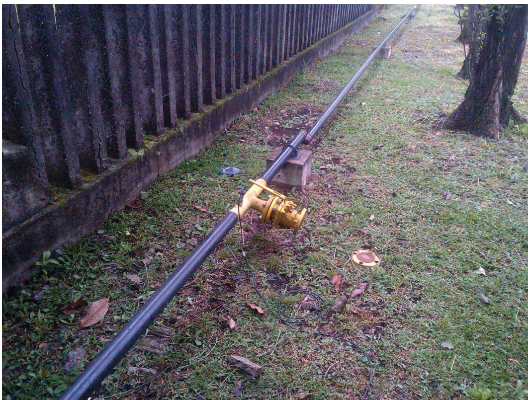
Figura 5.2 – Detalhe da válvula no final da rede (fonte: O Autor, 2015).
