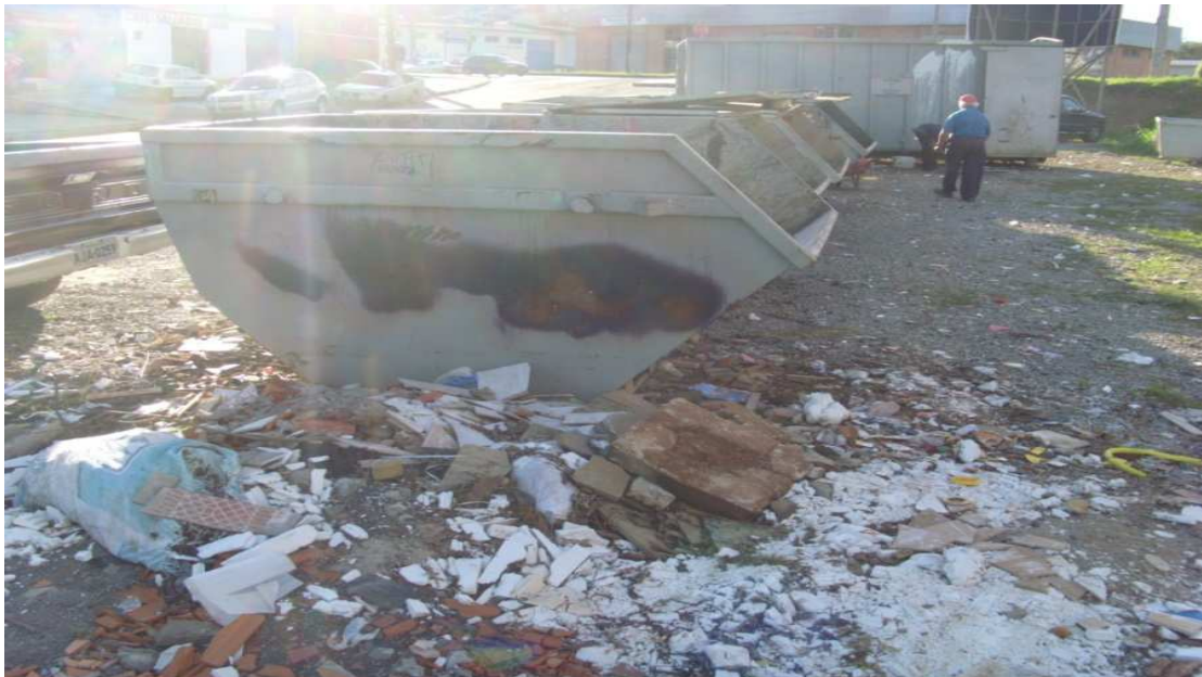
Figura 29 - RCD depositado fora da caçamba
