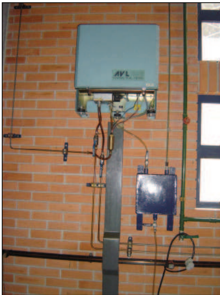
Figura 24 – Balança de combustível diesel.
