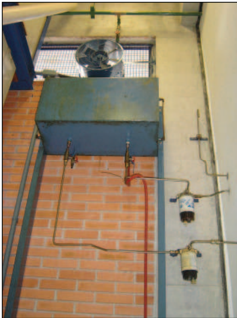
Figura 22 – Tanque de óleo diesel.
