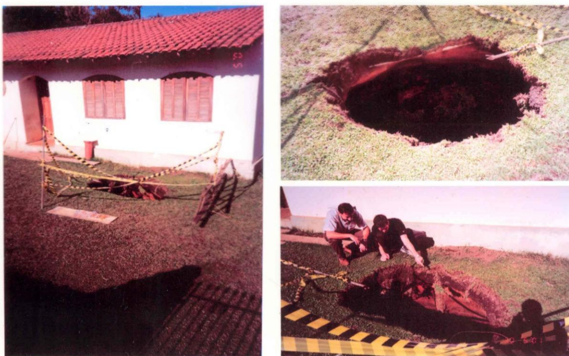
FIGURAS 2.8 2.9 – COLAPSO NATURAL DE SOLO (DOLINA) EM ÁREA CÂRSTICA COM DIMENSÕES 1,90 M X 1,50 M X 3,00 DE PROFUNDIDADE FONTE: Mineropar (2005)
