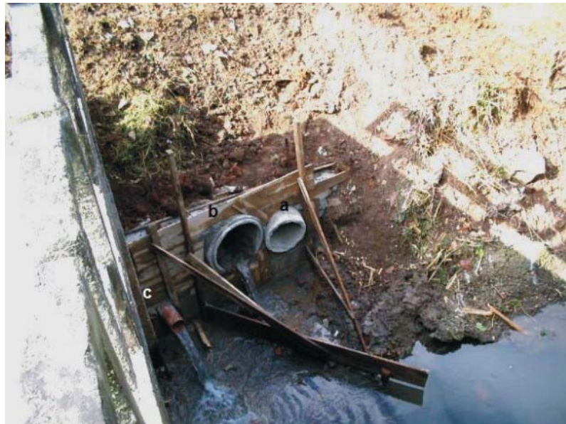
Figura 9 - Local apresentando três situações diferenciadas: (a) galeria de água pluvial seca; (b) galeria de água pluvial lançando "água"; e (c) tubulação do sistema de coleta de esgoto da Concessionária lançando "esgoto"
