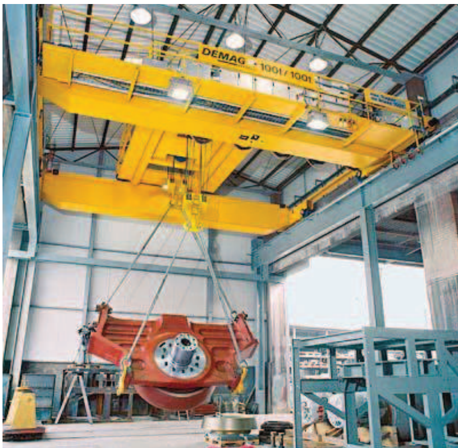
Figura 53 – Imagem de uma ponte rolante industrial com capacidade máxima de 200 tf, por meio de dois guinchos elétricos no trole, com capacidade de 100 tf cada um.
