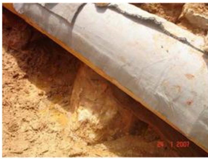
Figura 6 – Mossa, esmagamento em duto (Pereira, 2007)
