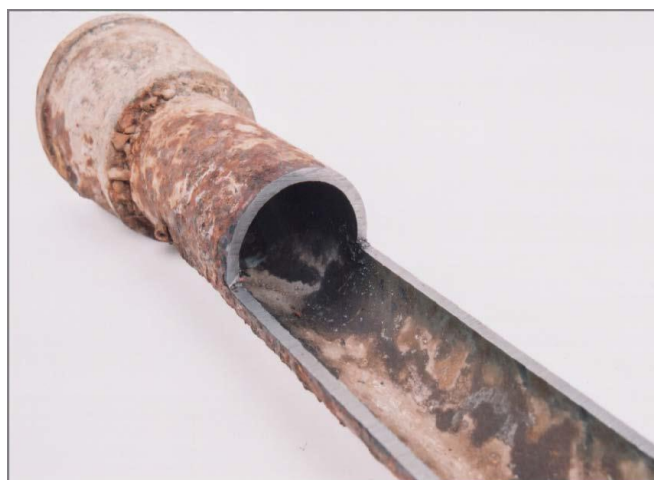
Figura 1 – Duto com corrosão interna e externa
