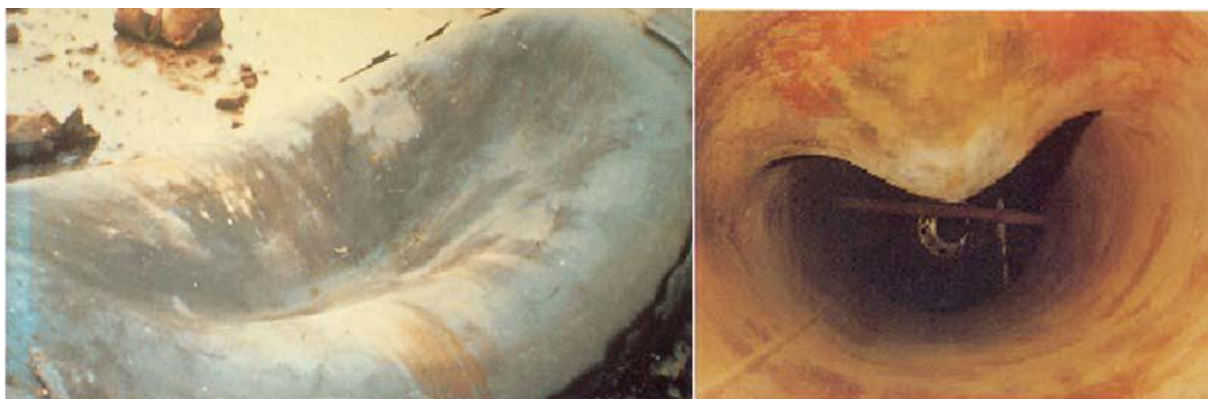
Figura 5 – Mossas em dutos, (a) vista externa, (b) vista interna. (Defeito em um duto de petróleo em Macaw)
