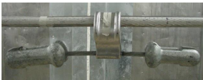
Figura 35. Amortecedor tipo Stockbridge assimétrico instalado na amostra Fonte: O autor.
