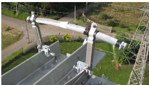
Figura 25. Peça de cabo condutor instrumentado com termopar tipo T Fonte: O autor.
