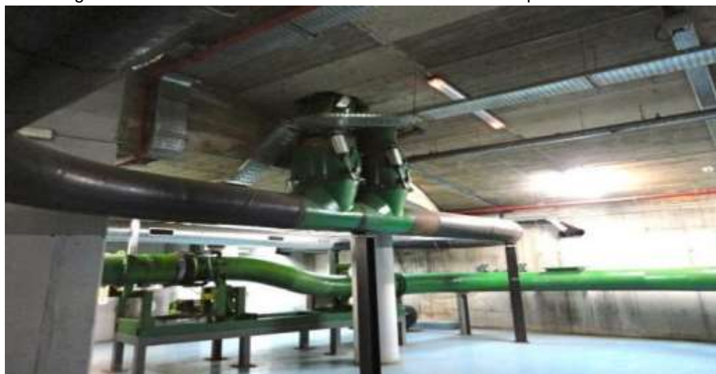
Figura 9. Dutos subterrâneos onde os resíduos são transportados a vácuo
