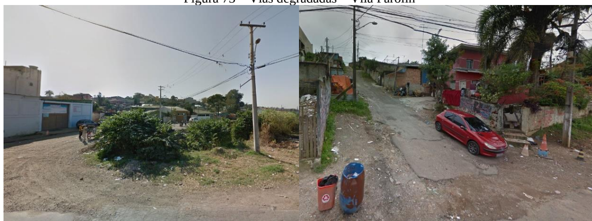
Figura 73 – Vias degradadas – Vila Parolin
