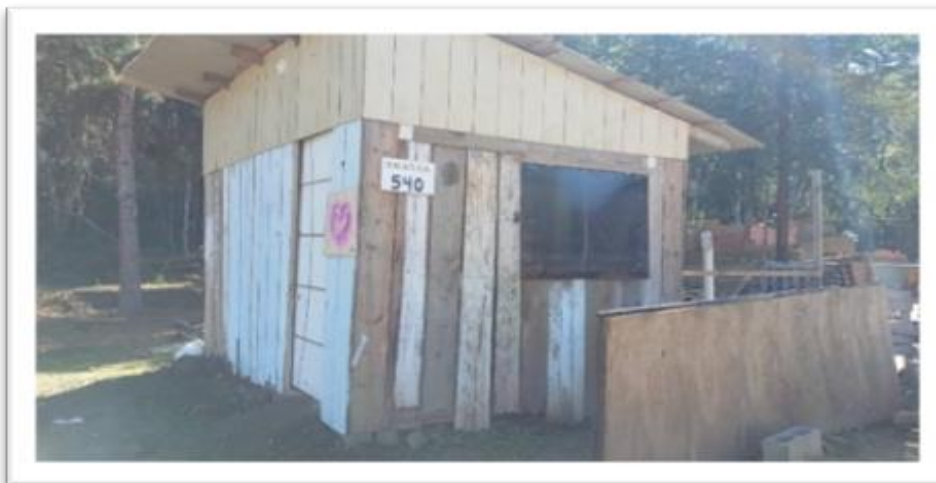
Figura 7 - Casa de madeira sem caixa d'água
